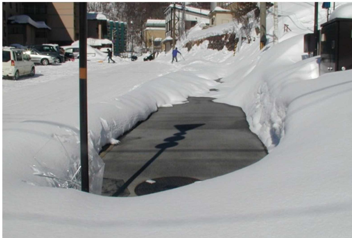
温泉熱を活用した融雪設備
